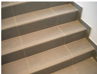
Treppenstufen, taktile aber nicht visuell kontrastreich.
